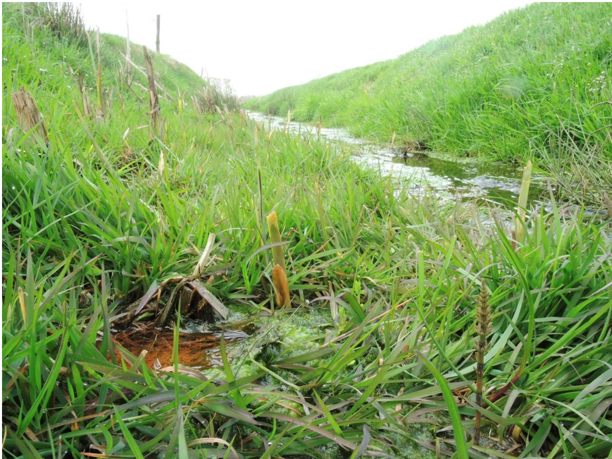
Foto 1 Diepe sloot in Verkooijen met in de oevers uittreden roestrood grondwater. Het afkalven van de slootoever wordt veroorzaakt door het uittreden van dit grondwater onder hoge intensiteit, waardoor de oever wordt ondermijnd.
